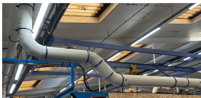
Nos tuyauteries permettent d'évacuer les fumées vers l'extérieur.
