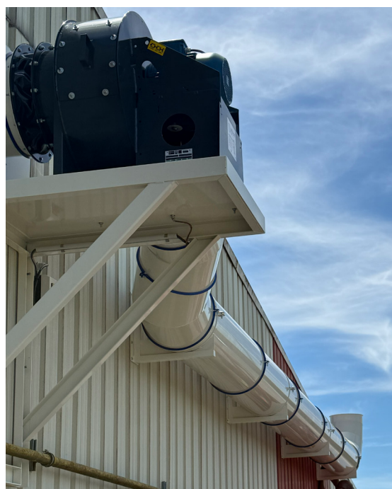
Le nouveau moteur d'aspiration avec son évacuation extérieure.
